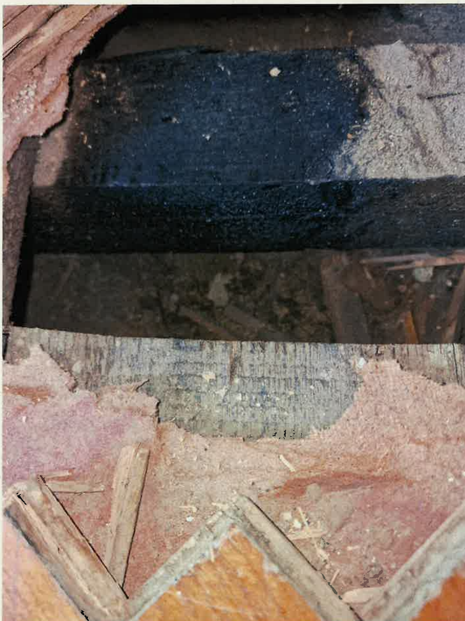
Sala D.222 – odkrywka konstrukcji podłogi, widoczny legar z drewna iglastego pokryty preparatem impregnującym, prawdopodobnie Xylamitem Popularnym , na co wskazuje ciemnobrunatna barwa elementu
